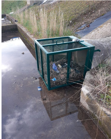
Nasse à déchets en place
