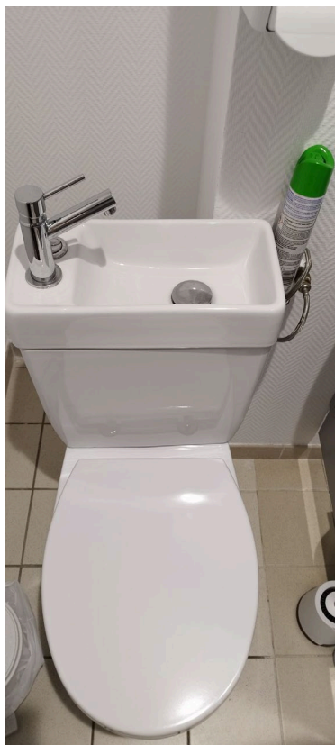
Eau de lavage des mains récupérée dans le réservoir des toilettes
